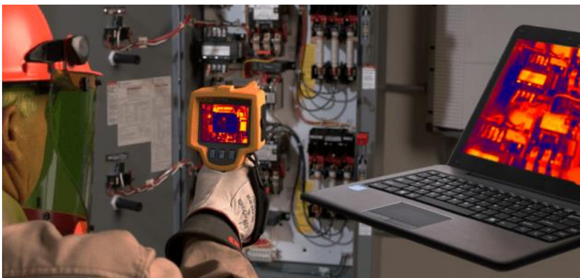
Рисунок 20. Пример проведения тепловизионного контроля электрошкафа
